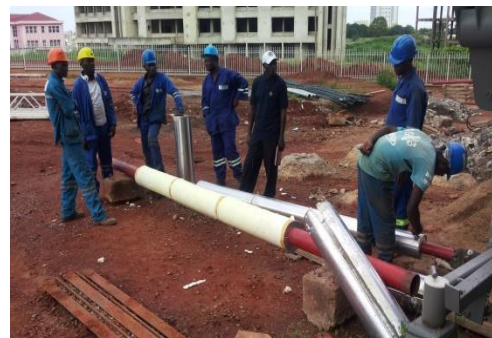
ESPUMA DE TUBOS LLENOS
